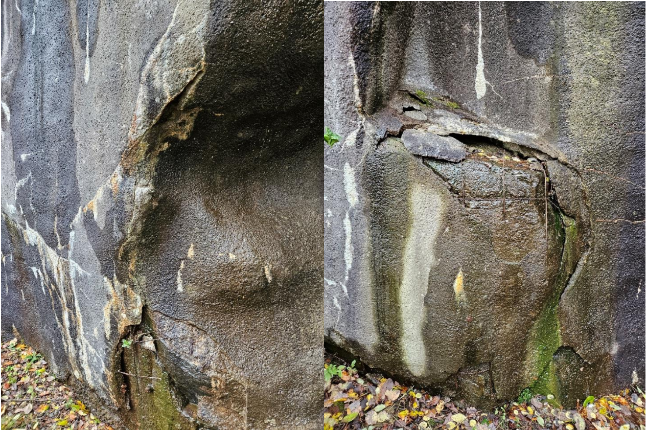
Figur 10 Fotografier av krackelering och släpp i den armerade sprutbetongen i södra delen av den befintliga slänten. Se skada 4 i figur 8.
