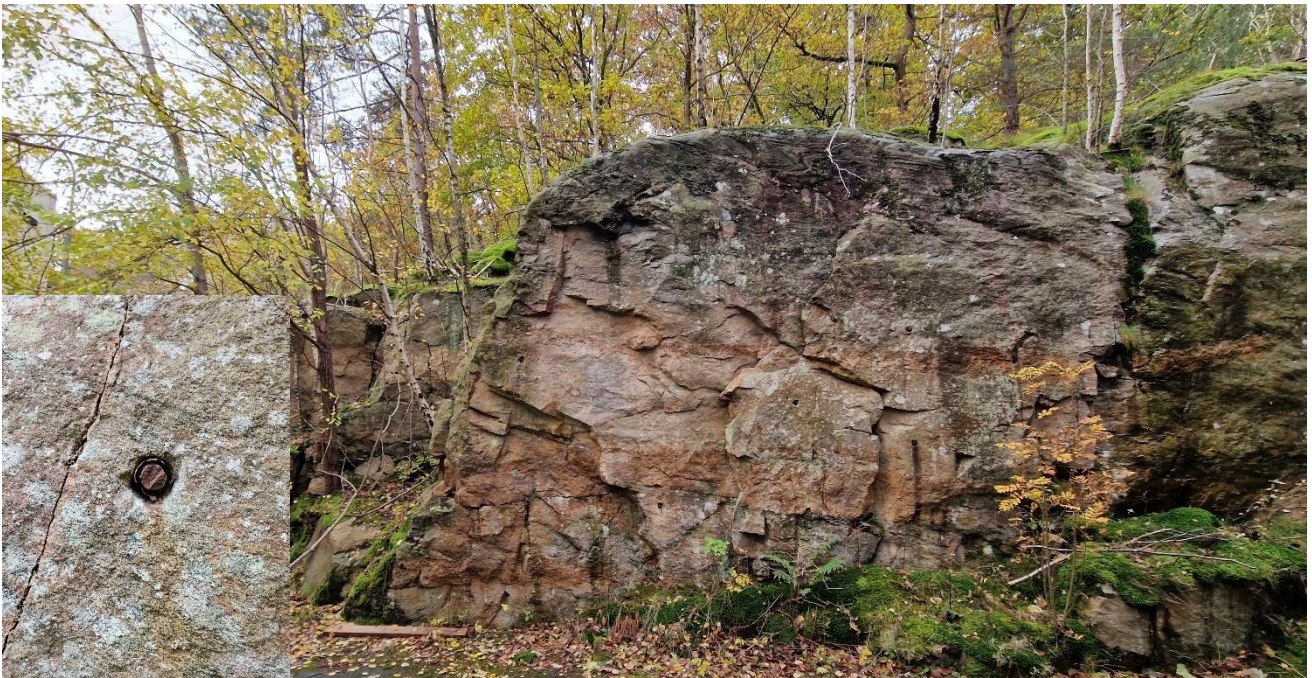
Figur 1 Fotografi av 25 mm perforerade bergbultar i den befintliga slänten. Nere till vänster är en exempelbild på korrosion av bergbultarna.
