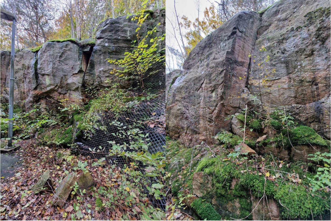
Figur 3 Fotografier av blockutfall i den befintliga släntens norra del. Utfallet till vänster är kilformat. Se skada 2 och 3 i figur 8.
