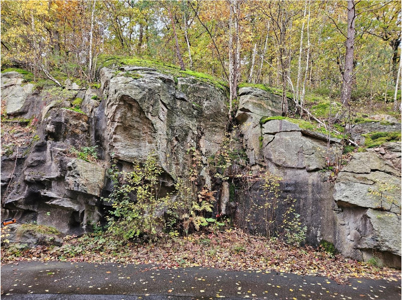
Figur 5 Fotografi av vegetation som har fått fäste i sprickor i den befintliga slänten och som kan komma att påverka bergskvaliteten i framtiden. Se skada 6 i figur 8.
